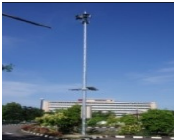
Sistem Siren Tsunami Tsunami Siren System
